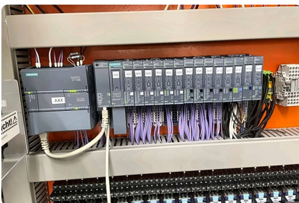
Neuer Elektroschrank nach dem Umbau.
