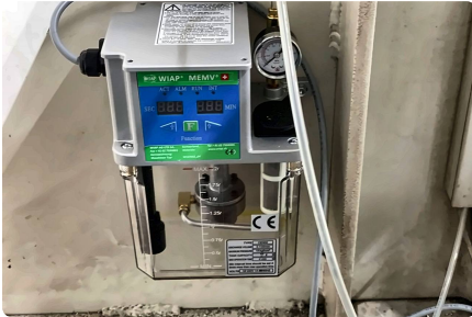
Schmierpumpe mit Ölniveau-Kontrolle und Alarm.
