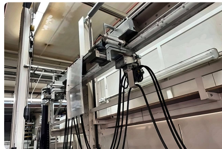
Verkabelung der Ventile und Zylinder.
