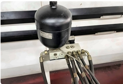
Druckspeicher am Servoventil.
