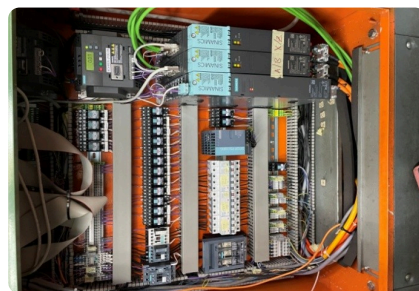
Neue Elektrik nach dem Umbau.
