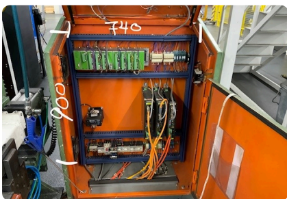
Schaltschrank vor dem Umbau.
