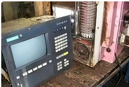
Alte Steuerung vor dem Ersatz.
