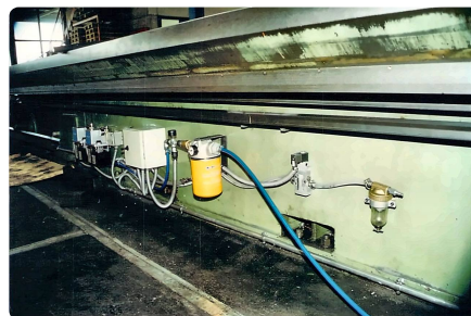
Einspeisung mit Filter und Steuerkasten.
