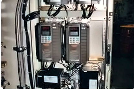
Elektrik direkt an der Maschine.
