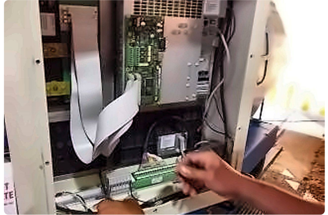
Etwa 30 % der früheren Kabellänge: aufgeräumt und servicefreundlich.
