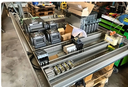
Elektroschrank im Aufbau.
