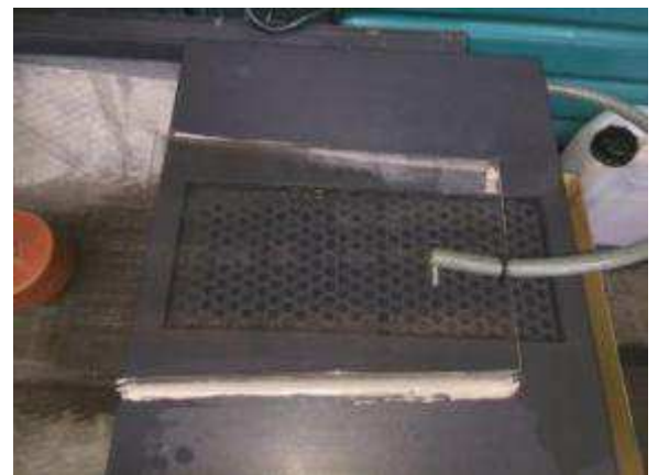
Bild 57e: Eintritt des Wasser vom Förderer.
