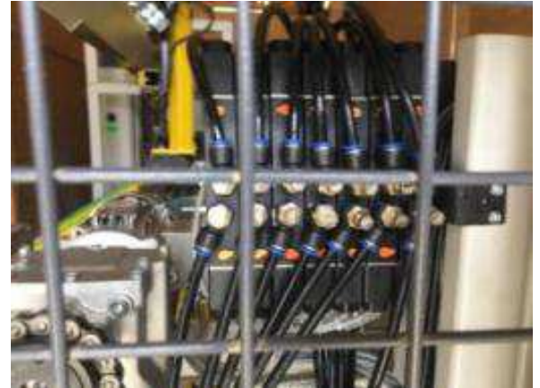
Bild 46c: Dieser Ventilblock steuert die ganze Automation. Manuell können hier auch Bewegungen erzwungen werden, wenn ein Ventil nicht von der Steuerung permanent angesprochen wird. Sonst geht es nur, nach dem Notstopp drücken.
