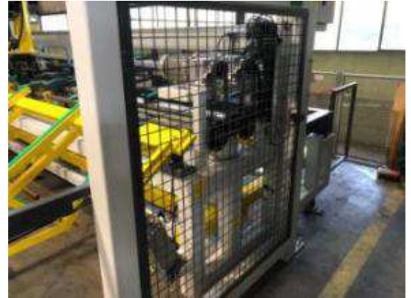
Bild 58a: Die ganze Anlage ist mit 3 Schutzgitter geschützt. Geschraubt. Trotzdem mit Lichtschranken. Ansicht von hinten.
