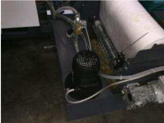
Bild 57f: Im Bandfilter ist die Hauptpumpe, welche die ganze Maschine speist. Wenn zu wenig Wasser, kommt zuerst eine Warnung und dann geht die Anlage in den Stopp Modus und sagt dem Bediener, was zu tun ist.
