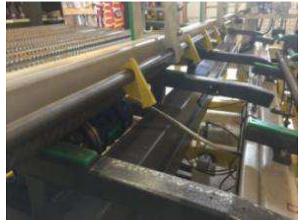
Bild 13a: Hier sieht man rechts die Lichtschranken in der Vorablage Position.
