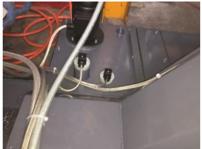
Bild 57d: Der Späneförderer hat einen Schalter, Level oben und Level unten, und pumpt automatisch das Wasser zum Bandfilter.
