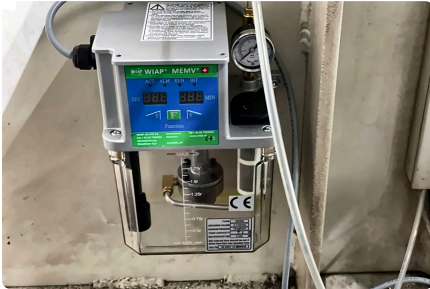
Schmierpumpe mit Ölniveau-Kontrolle und Alarm.
