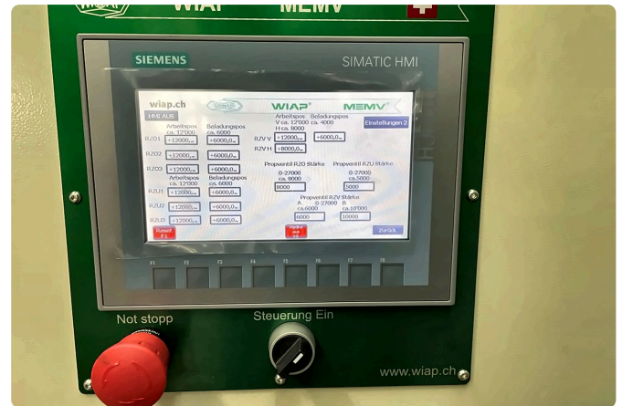
Neues HMI am Bedienpanel.
