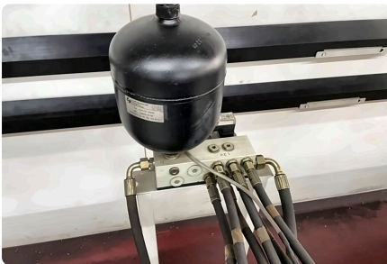
Druckspeicher am Servoventil.
