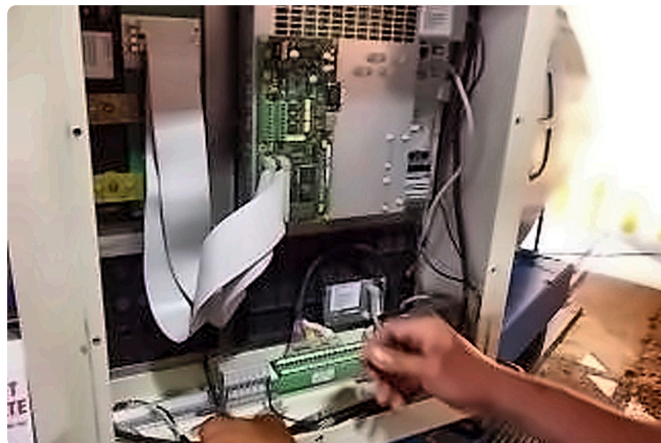
Etwa 30 % der früheren Kabellänge: aufgeräumt und servicefreundlich.
