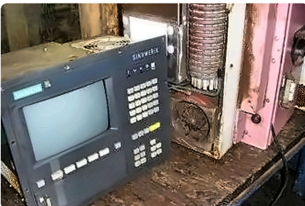
Alte Steuerung vor dem Ersatz.
