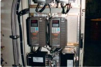
Elektrik direkt an der Maschine.
