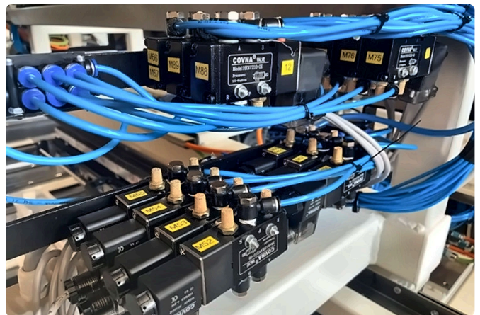
Ventile der Pneumatik, alle per M-Funktion aus dem CNC-Programm gesteuert.
