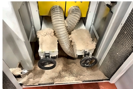
Späne im Arbeitsraum.
