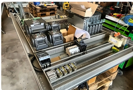
Elektroschrank im Aufbau.
