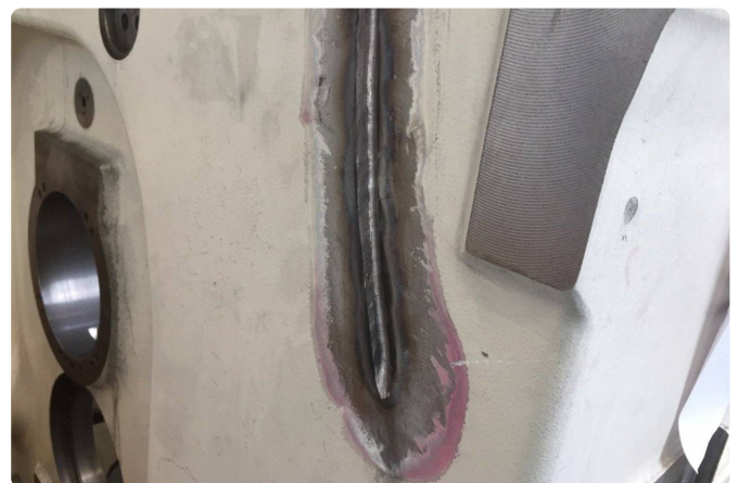
Bei anderen Teilen führen die Spannungen sogar zu Rissen.
