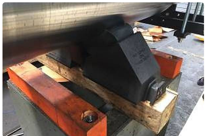
Gummiunterlagen unter der Walze: Sie verhindern, dass Schwingungen in die Halle übertragen werden.
